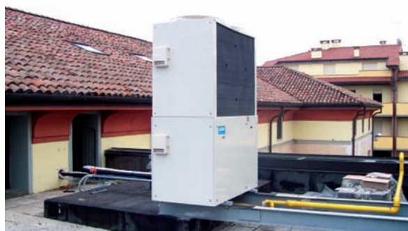
Figura 1. Bomba de Calor a gas instalada en cubierta
